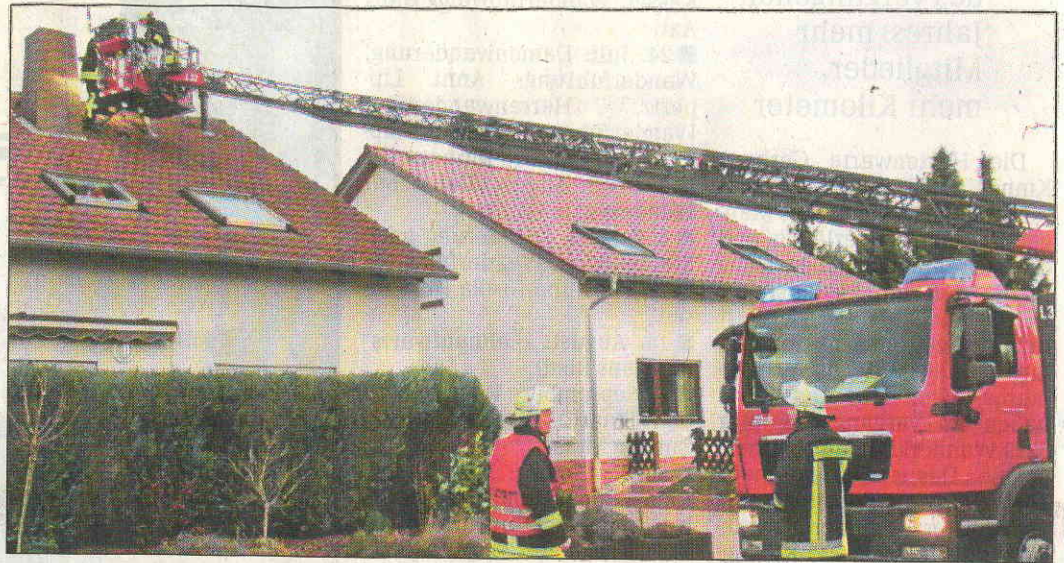
In Kirchhain sind Teile eines Schornsteins abgebrochen und aufs Hausdach gestürzt. Die Feuerwehr musste mit der Drehleiter ausrücken. (Foto: Lindner)
